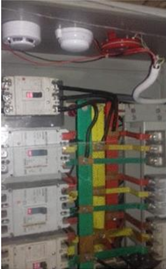
DSPA 11-1 lắp đặt bên trong tủ điện
