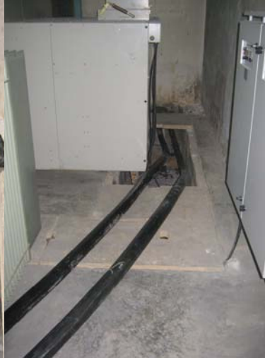
Rentangan kabel ke dalam PE FPP Lama
