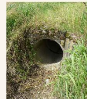
PONTE IN TUBI DI CEMENTO CON INCASTRO ALL'IMBOCCO DI 1,40 X 0,80 M. PARATOIA DOLCE BUOLA AL ML. 0,80 X 0,80 M
